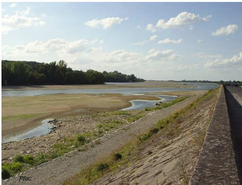
Document 2a : les levées ou digues sur le bord de la Loire
